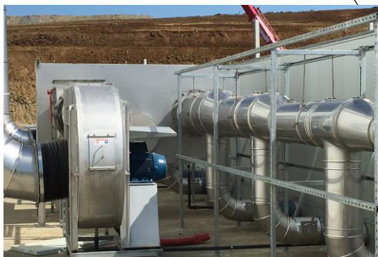
(1) SISTEMA DI VENTILAZIONE CONTROLLATO IN AUTOMATICO 24/7
