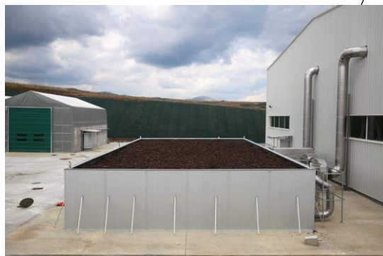
(2) BIOFILTRO PER ABBATTERE GLI ODORI DEL PROCESSO
